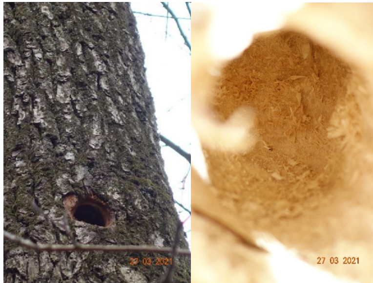
Abbildung 1: Bohrhöhle im Lohwald. rechts: Blick ins Innere, frisch gefräst. Foto: Fa. Bauroth.
